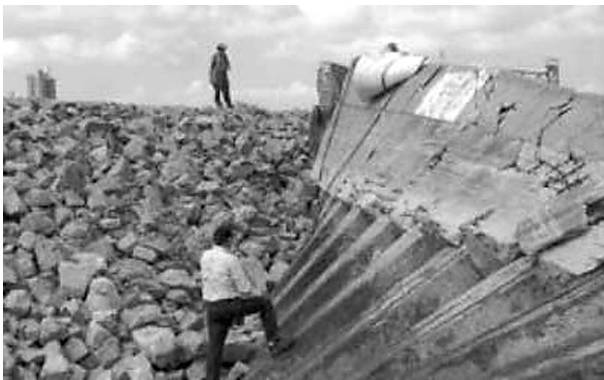
倒壊した堤防（礫は仮締切堤防）
