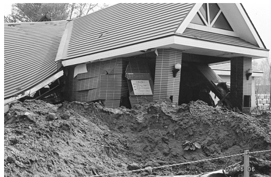
写真2 泥流により被災した読書館
