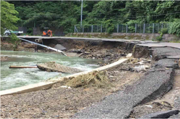
津保川（関市上之保地内）護岸被災状況
