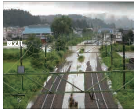
〈写真-4〉7月豪雨による浸水被害の状況(西又川)
