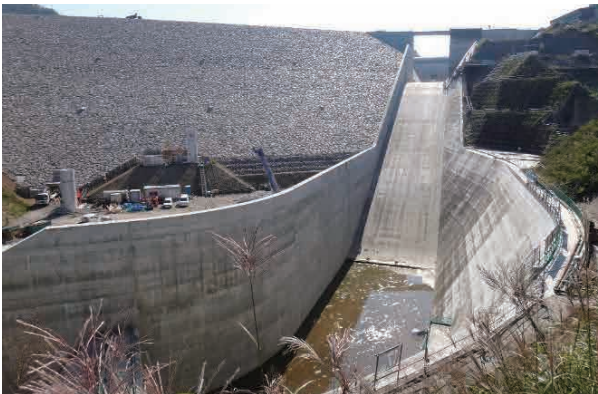
写真-4 減勢工コンクリート打設完了 (H29.10.26 ダムサイト左岸下流より望む)
