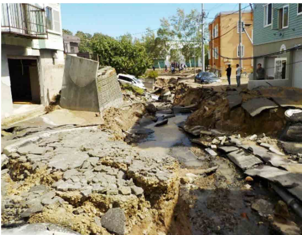
写真-13 液状化状況（北海道札幌市）
