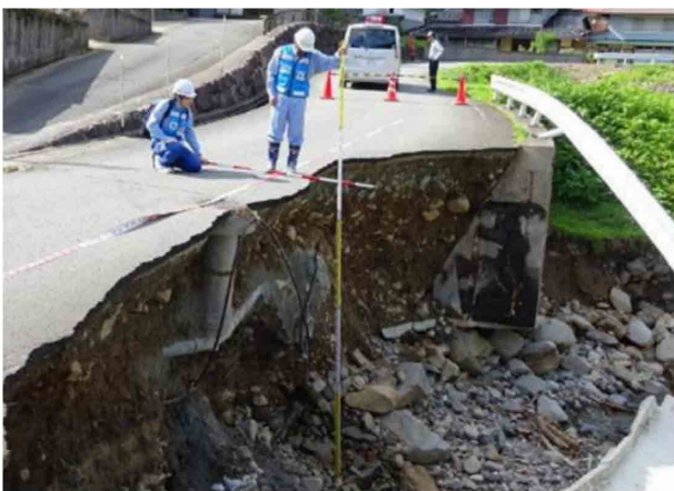
写真-9 TEC-FORCEによる被害状況調査 (岡山県倉敷市)
