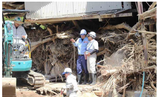
写真-8 まちなかに堆積したがれき等撤去の技術的支援(広島県呉市)
