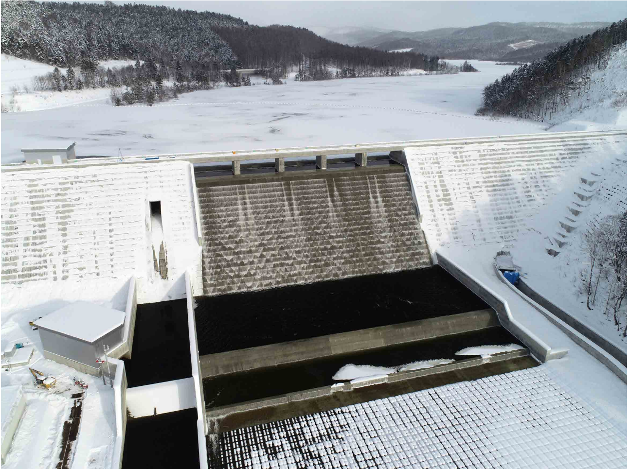
洪水時最高水位に到達し非常用洪水吐から越流している様子（H31年1月）
