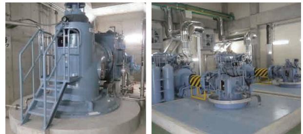
＜図-6＞ 増設設備（左がポンプで、右が減速機）
