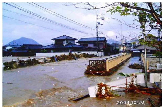
台風による春日川での被害状況(平成16年度)
