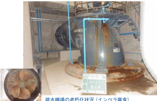
排水機場の老朽化状況(インペラ腐食)
