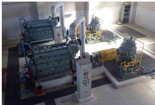
<写真-9>老朽化が進む原動機
