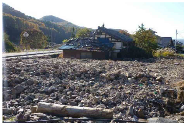
<写真-25>被災状況(西山沢(長野県佐久市))
