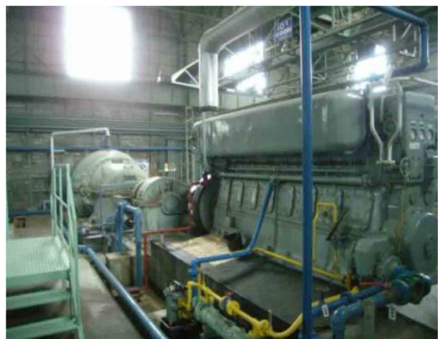
<写真-4>主ポンプ、減速機、原動機
