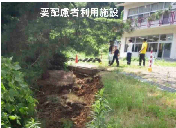
<図-17>急傾斜地崩壊の事例
