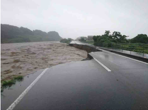
平成30年安芸川の堤防侵食状況
