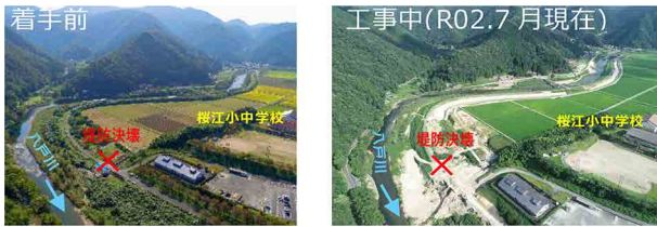
<八戸川 災害復旧状況>
