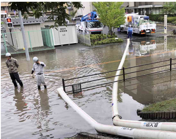
▲諏訪湖周辺の排水ポンプ車による排水状況(諏訪市)
