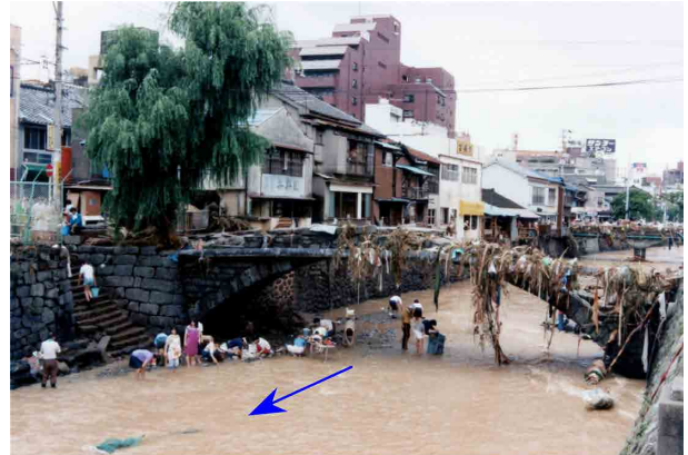
<中島川の石橋(袋橋)被災状況(提供: NBC長崎放送)>
