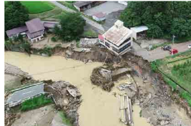
主要地方道長井飯豊線 橋梁崩壊 (山形県西直腸郡飯豊町)
