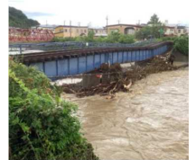
JR東日本・五能線 橋梁傾斜 (青森県西津軽郡野辺町)
