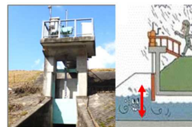
モーターでゲートを上下に開閉
