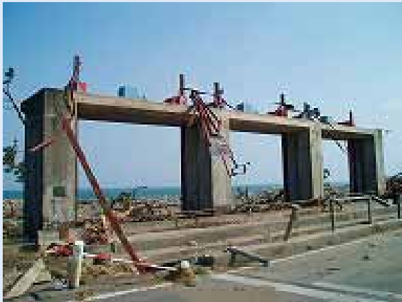
野田村 明内川水門 (震災後)
