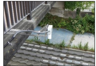
水位計の整備、改良
