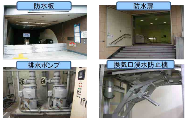
対象となる浸水防止用設備
