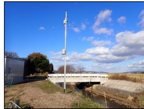
河川監視カメラの整備、改良
