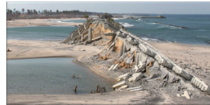
東日本大震災における堤防の破壊
