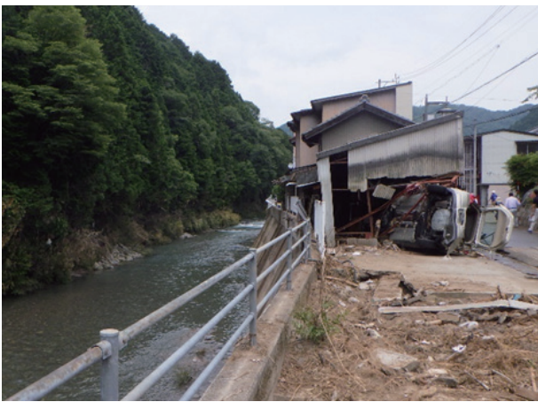
津保川の浸水害の状況(関市上之保地区)
