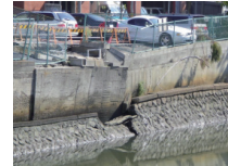
老朽化護岸の状況
