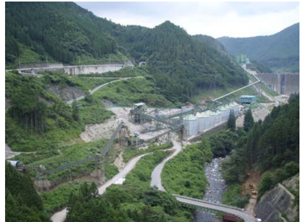
<写真-5> 骨材製造設備
