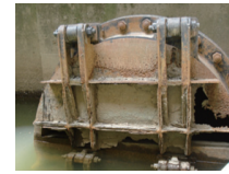
ポンプ設備の逆流防止弁の破損状況
