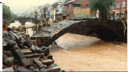
被災した眼鏡橋と袋橋（手前）
