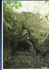
第15基目鼻線り (上方壁面に亀)
