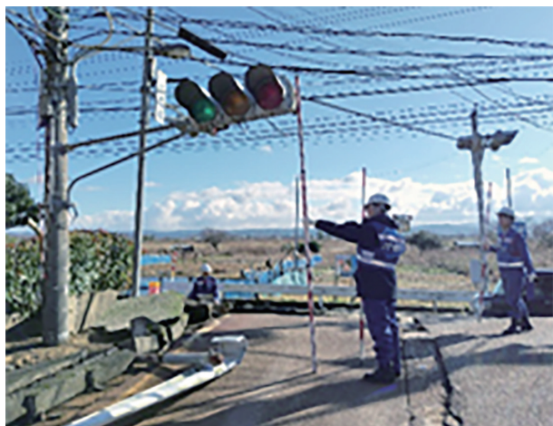
道路の被災状況調査（石川県内灘町）
