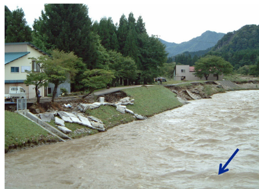
写真－ 6 被害状況（北秋田市五味堀地区）
