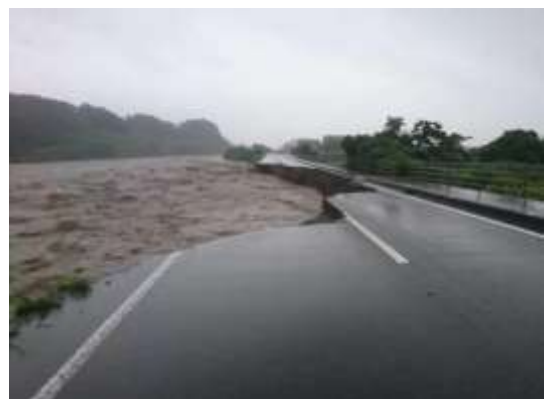
平成 30 年安芸川堤防侵食状況
