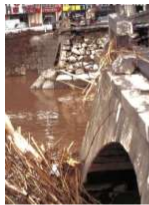
流失した新上橋
