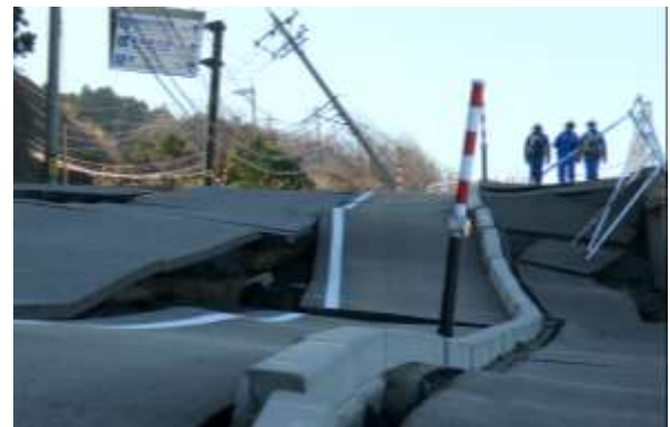
国道249号道の駅千枚田付近の被害
