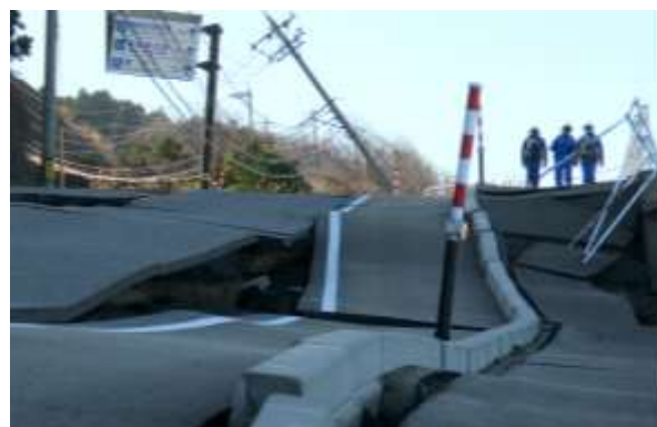
国道249号道の駅千枚田付近の被害
