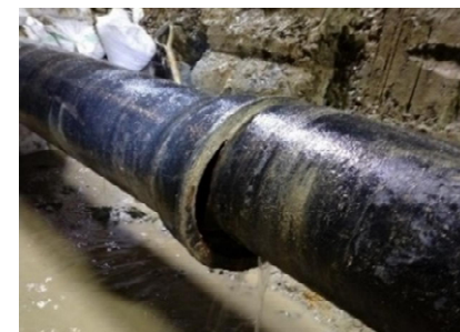
令和6年能登半島地震による既設管の抜け出し状況
