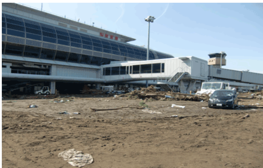
仙台空港被災状況
