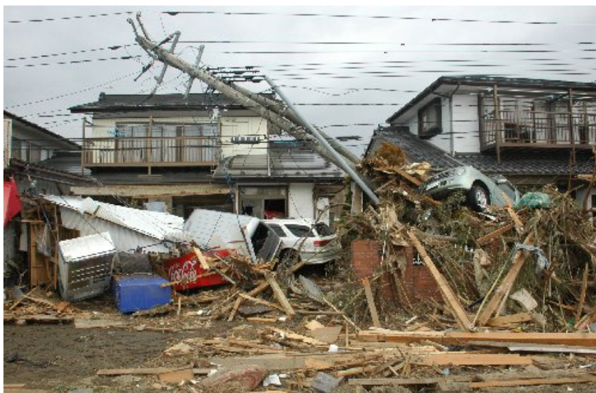
野蒜の駅前通りの住宅。自動車や瓦礫が1階に流入
