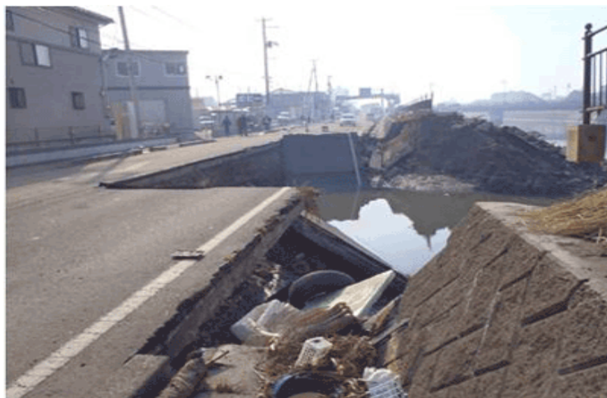
砂押川（多賀城市八幡付近）堤防破堤状況
