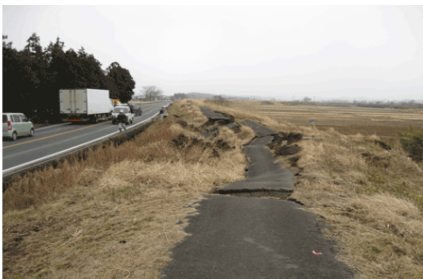
追川（登米市追町森付近）堤防沈下状況
