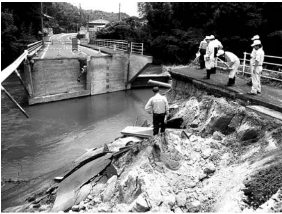
写真一 宮崎県都城市1級河川丸谷川の被災状況
