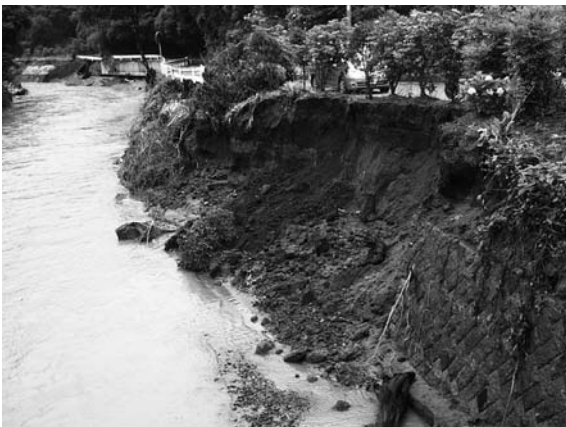
写真一 三 鹿児島県曾於市1級河川溝之口川・ 庄内川の被災状況
