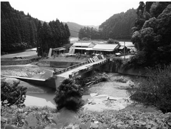
写真一 二 宮崎県都城市1級河川庄内川の被災状況
