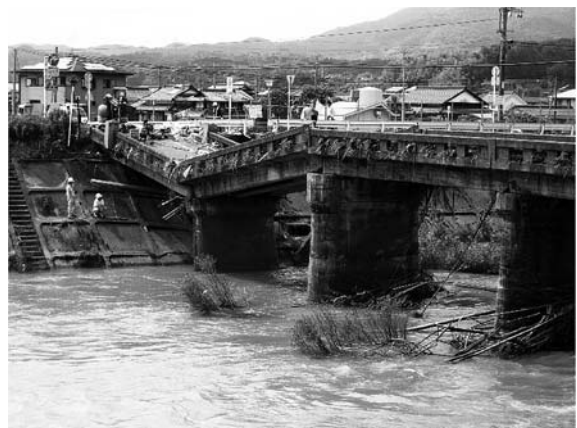
写真一六 山口県山陽小野田市厚狭川の被災状況
