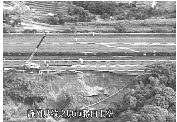
地震で法面路肩が崩壊した東名高速道路上り線 (静岡県牧ノ原市)
