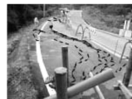
志津温泉北側に発生した地すべり(H17)
