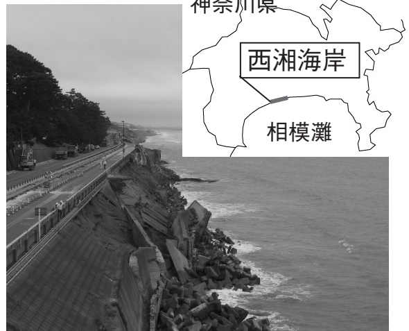
台風9号で大規模に海岸侵食が進行した西湘海岸
