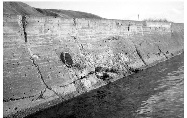
堤防の表法被覆工が損傷
