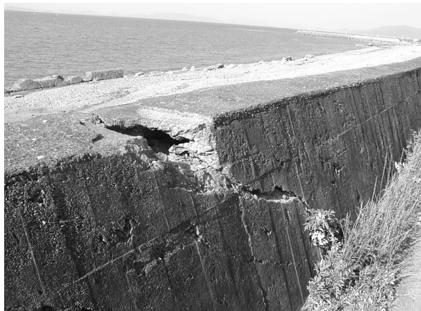
堤防の波返工が損傷
