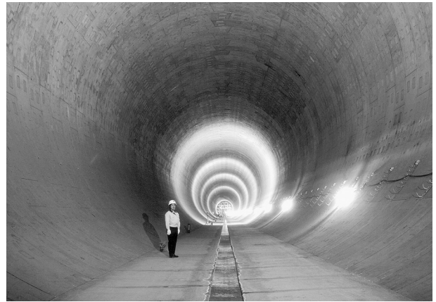
写真1 神田川・環状七号線地下調節池貯留トンネル
