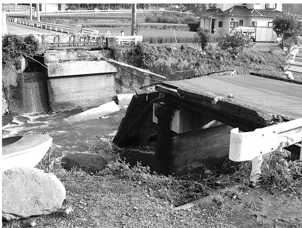
平成17年8月台風11号による狩野川支川 来光川の被害状況（静岡県伊豆の国市）
