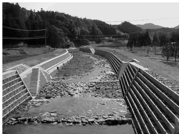
写真1 護岸の植生に配慮して環境保全型ブロックを用いているが、標準断面による画一的な工事が行われ、河床部や水際部には工夫が見られない。
