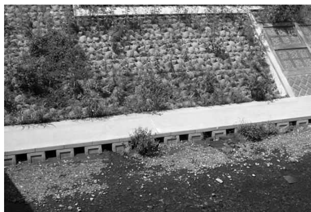
写真2 魚巢ブロックをとりつけたが、前面に州がついてしまって、魚巢ブロックの機能がなくなってしまった。
