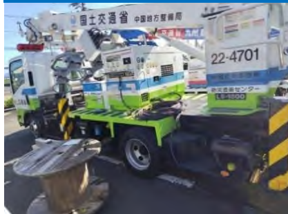
避難所へ照明車からの電源支援(熊本県氷川町)
