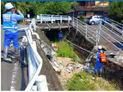
河川の被災状況調査(熊本県氷川町)
