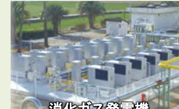
消化ガス発電機
